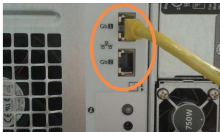
Kuva 16-5: LIS -ominaisuuden Ethernet-portit
